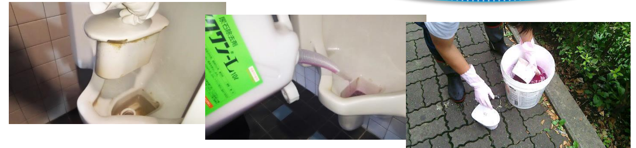
小便器の目皿部分は薬剤を注入して悪臭の原因である尿石を除去します。
