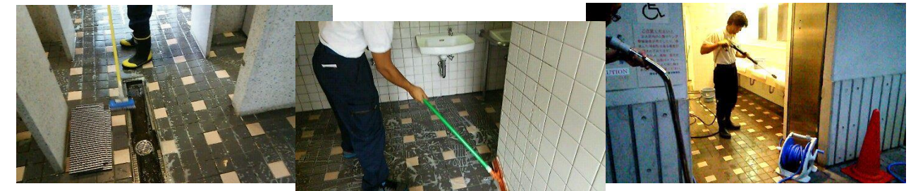
床面、排水溝、壁面に至るまで手作業で念入りに擦り洗いして最後に高圧洗浄により仕上げます。
